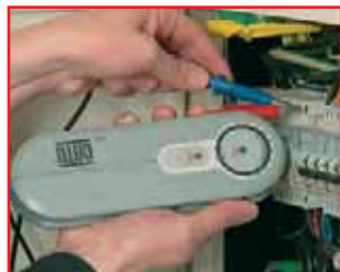
Photo prise sur installation consignée hors tension.
